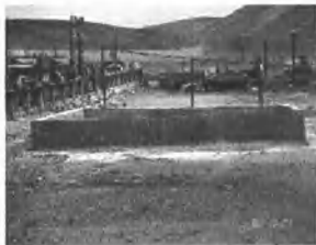
图4 混凝土集中拌合站的废渣处理池
