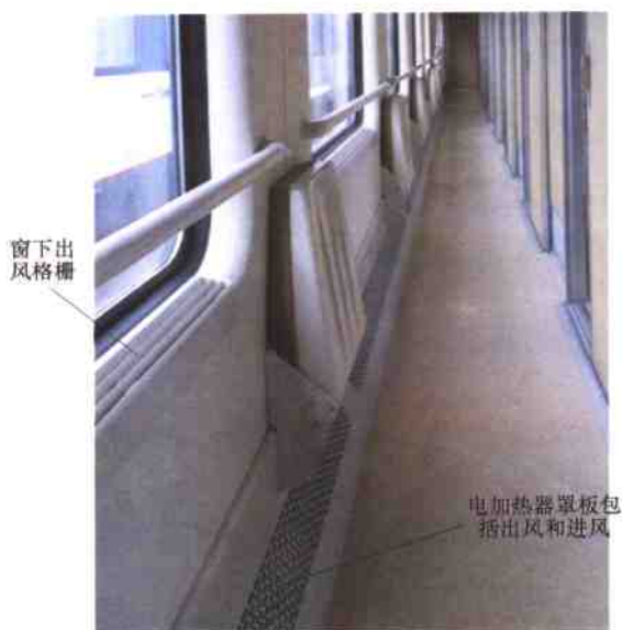
图 9.3 走廊电加热器
