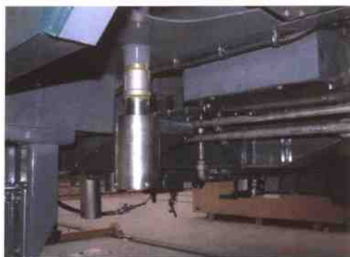
图 8.6 废气排放消音器
