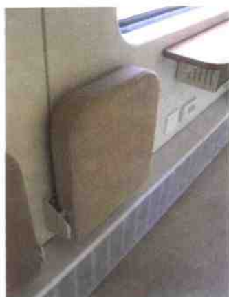
图 9.2 走廊电加热器
