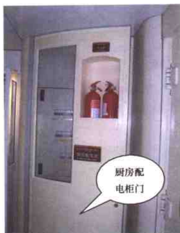
(a) 厨房配电柜门
