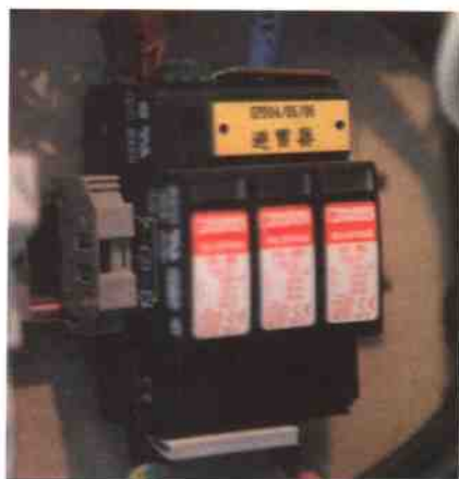
图 7.7 车内电气设备防雷浪涌装置
