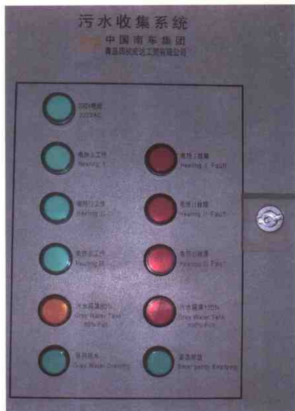
图 10.30 污水收集系统电控单元面板图
