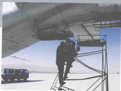
安装人工增雨设备
