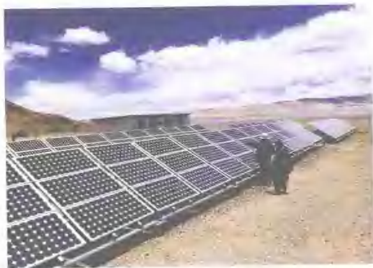
西藏清洁能源利用。图为光伏电站太阳能板。
