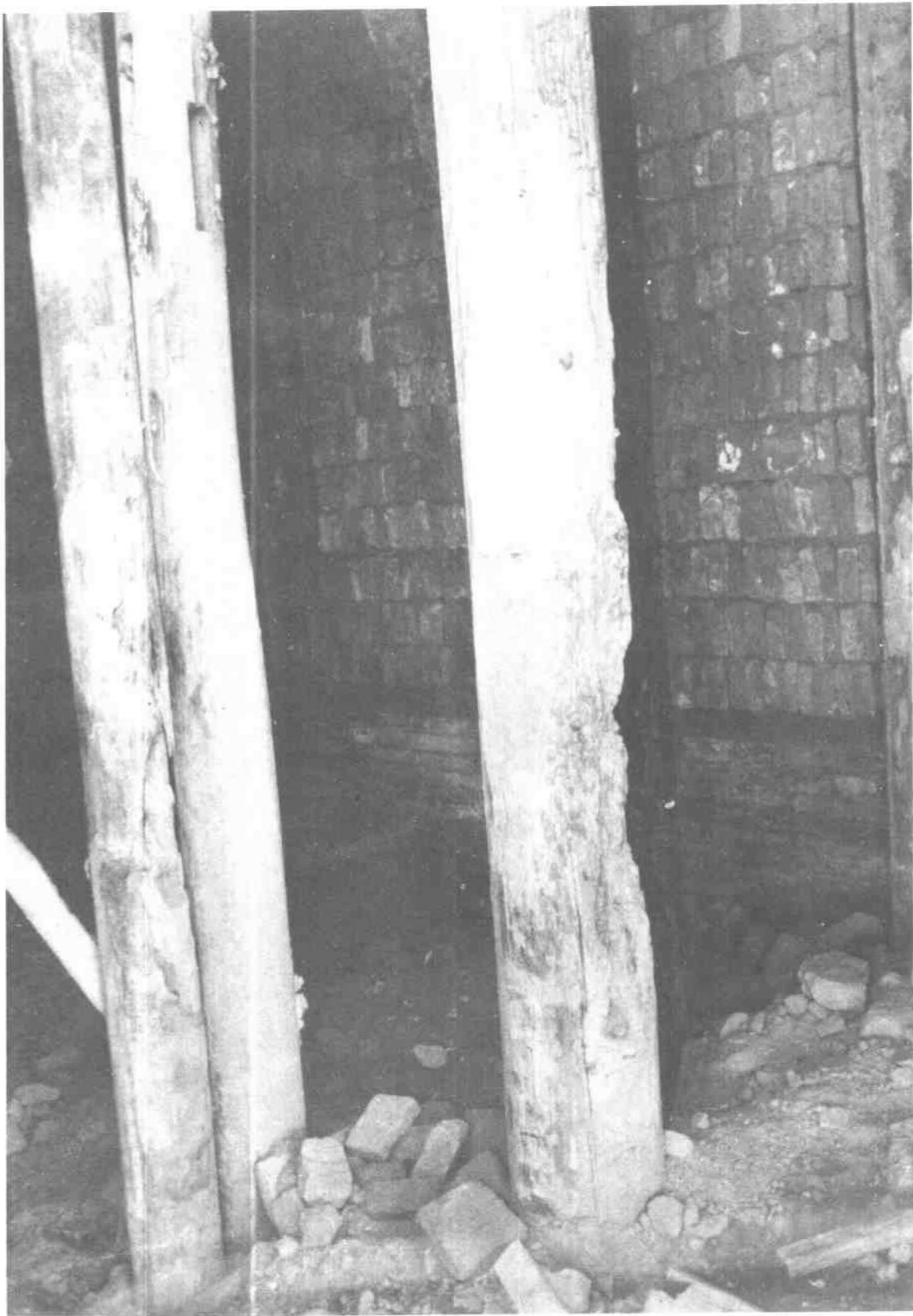
一三 維修前達賴、班禪行宮木構件腐朽殘狀
