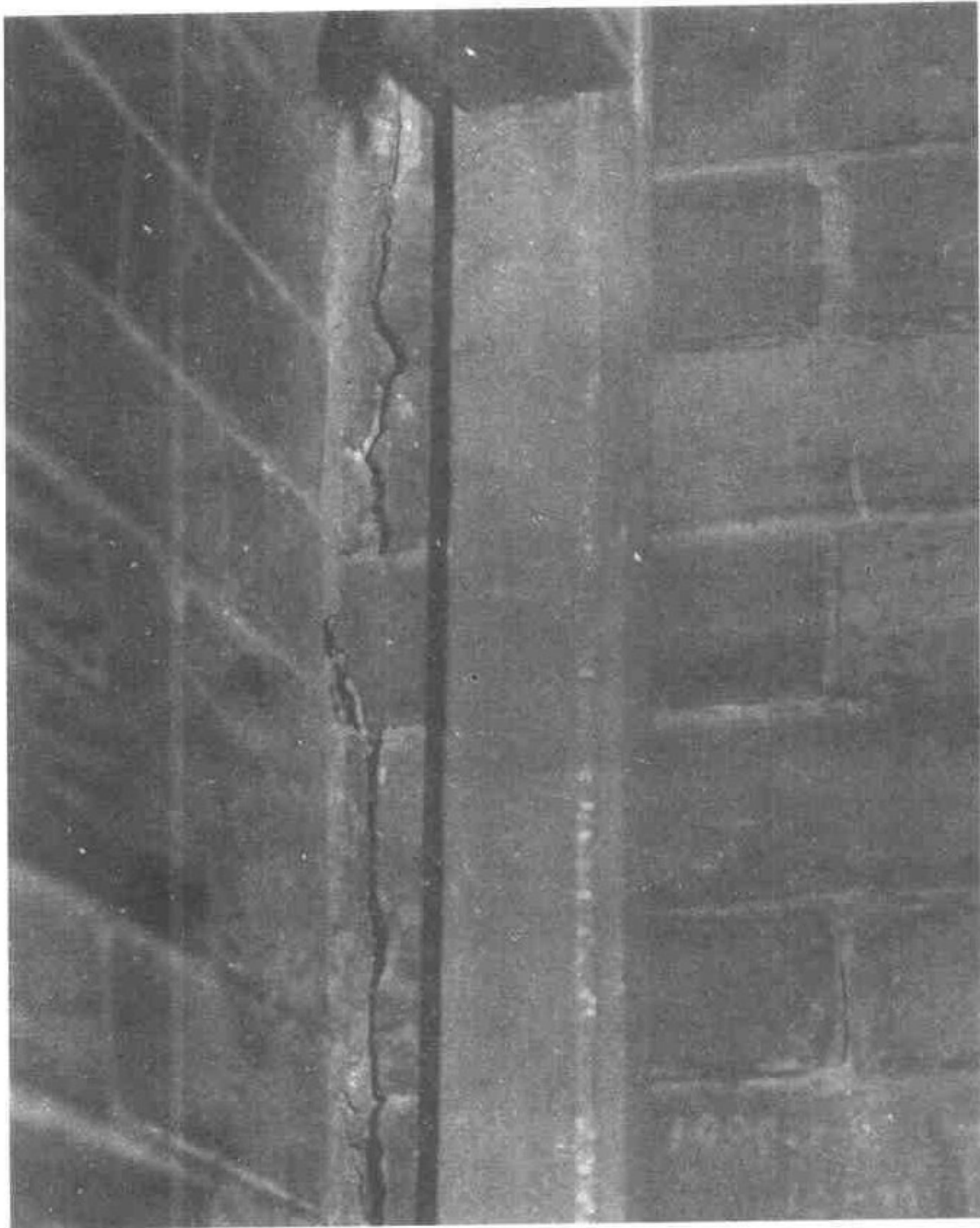
二〇 維修前大金瓦殿內壁開裂殘狀
