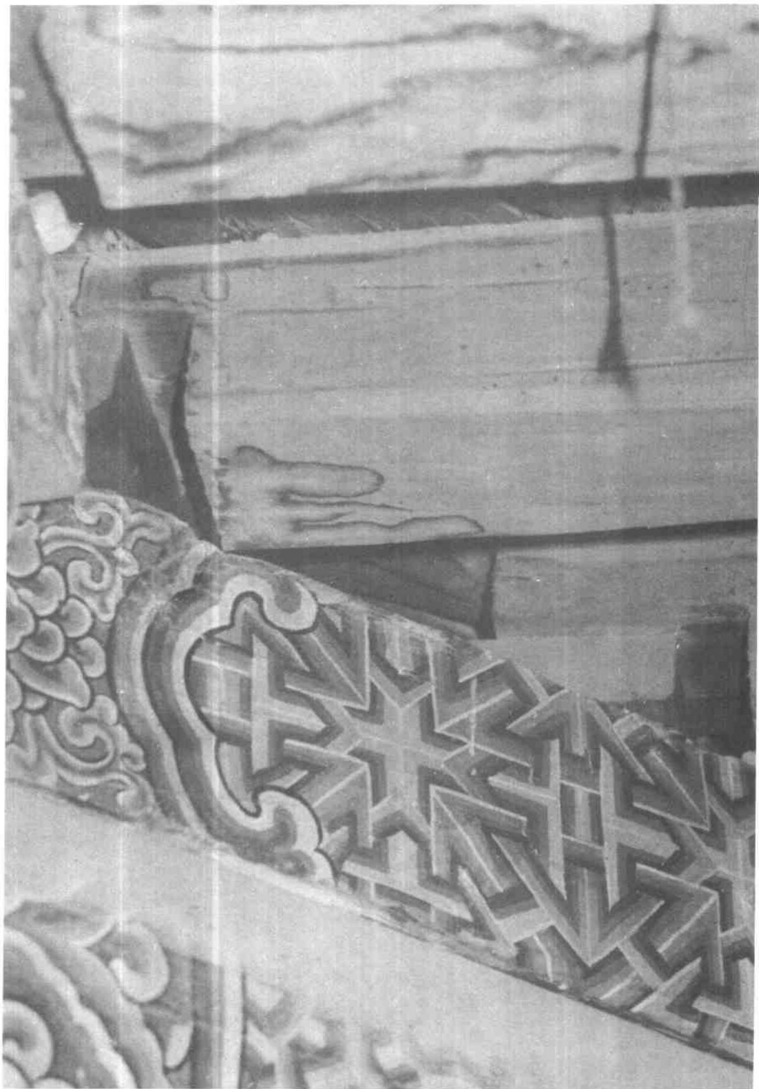
二二 維修前大經堂二層椽子脫榫劈裂殘狀
