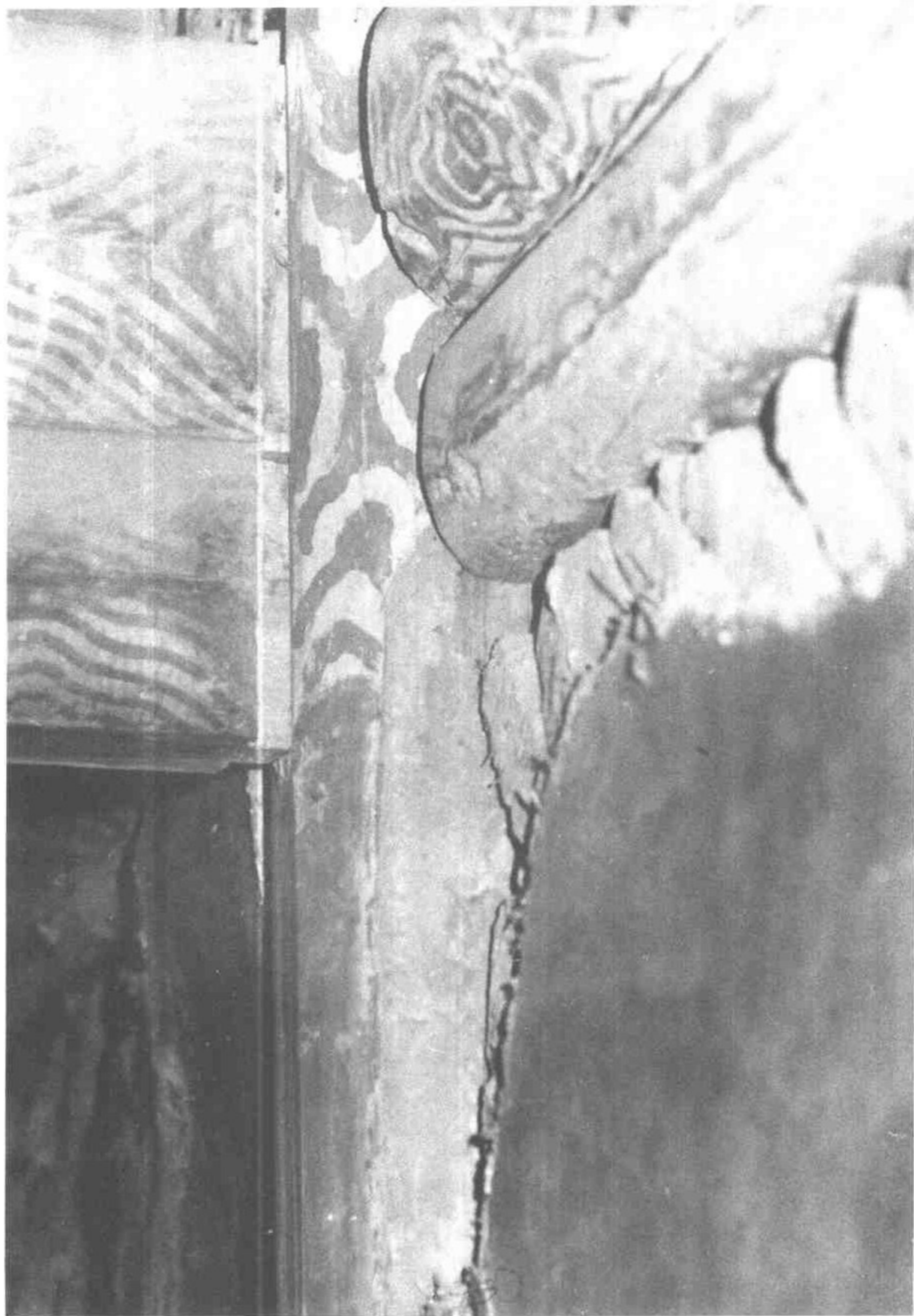
七 維修前護法神殿二層內壁開裂殘狀
