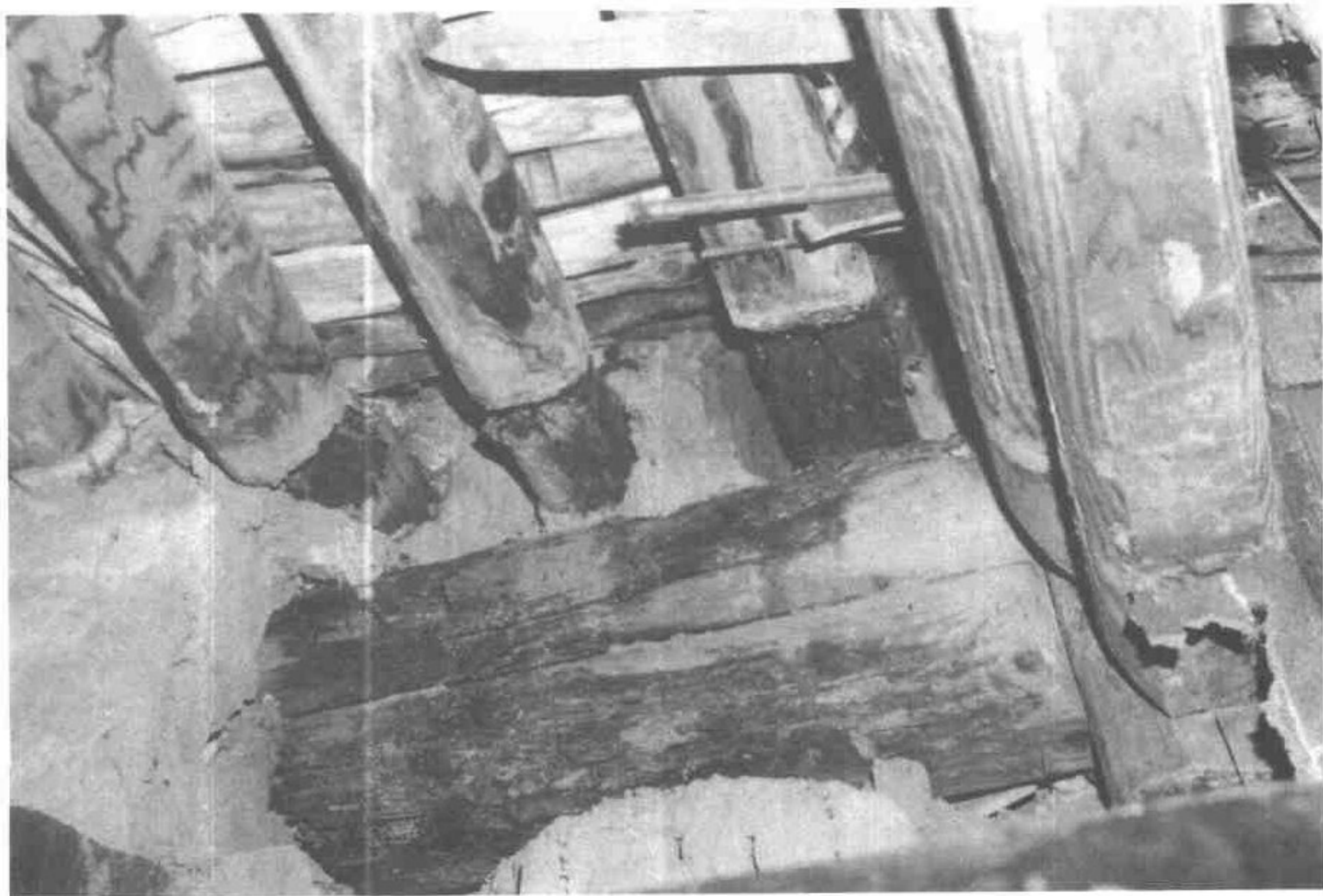
二三 維修前大經堂二層椽子腐朽殘狀
