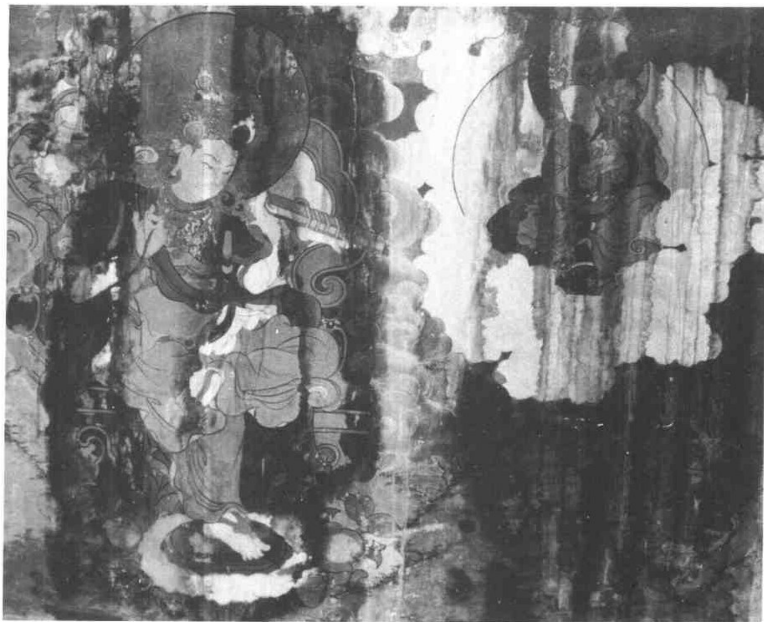
八 維修前護法神殿壁畫遭雨開裂殘狀
