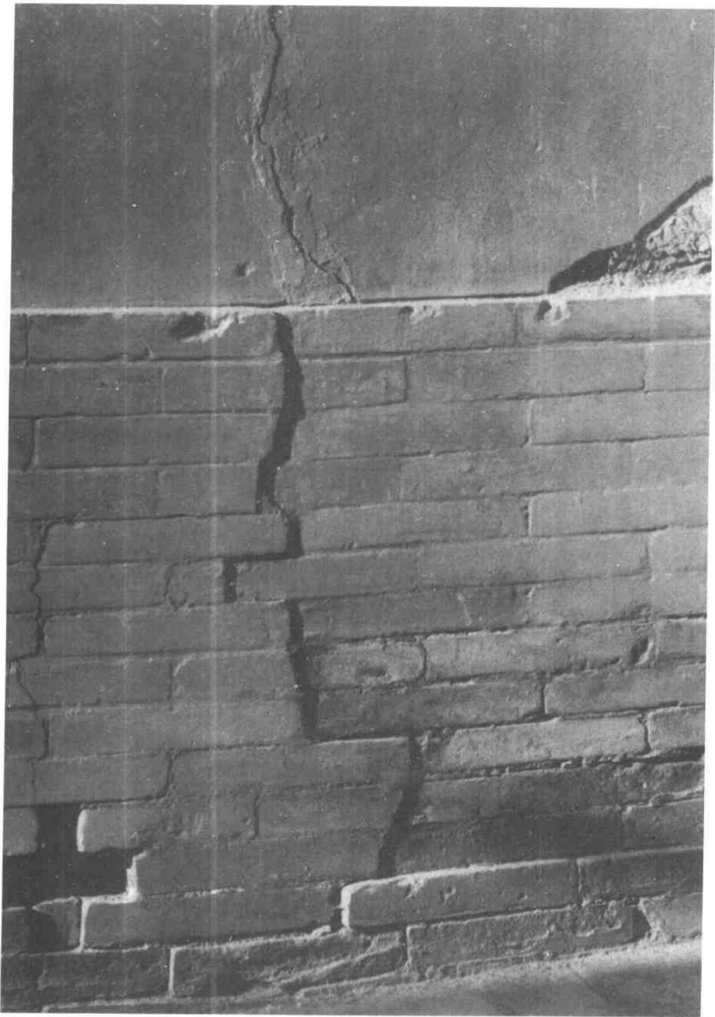
一二 維修前達賴、班禪行宮外壁開裂殘狀
