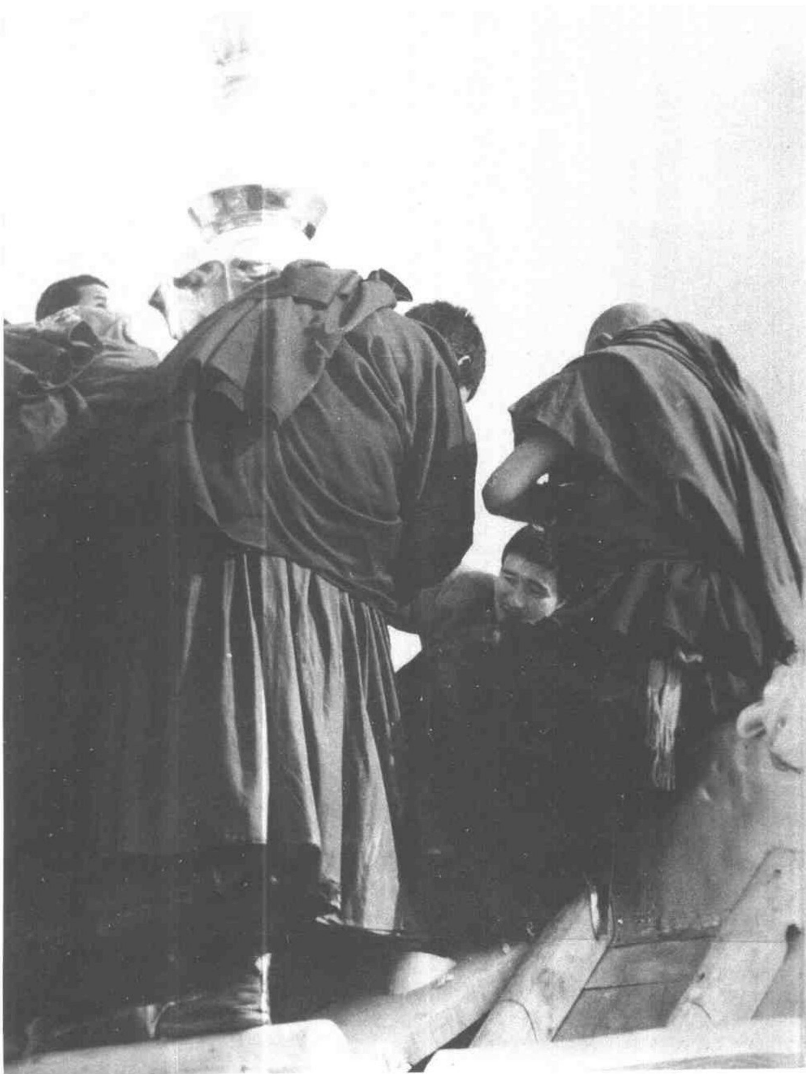
四四 維修中按照佛教儀軌安裝護法神殿金頂寶瓶的情景
