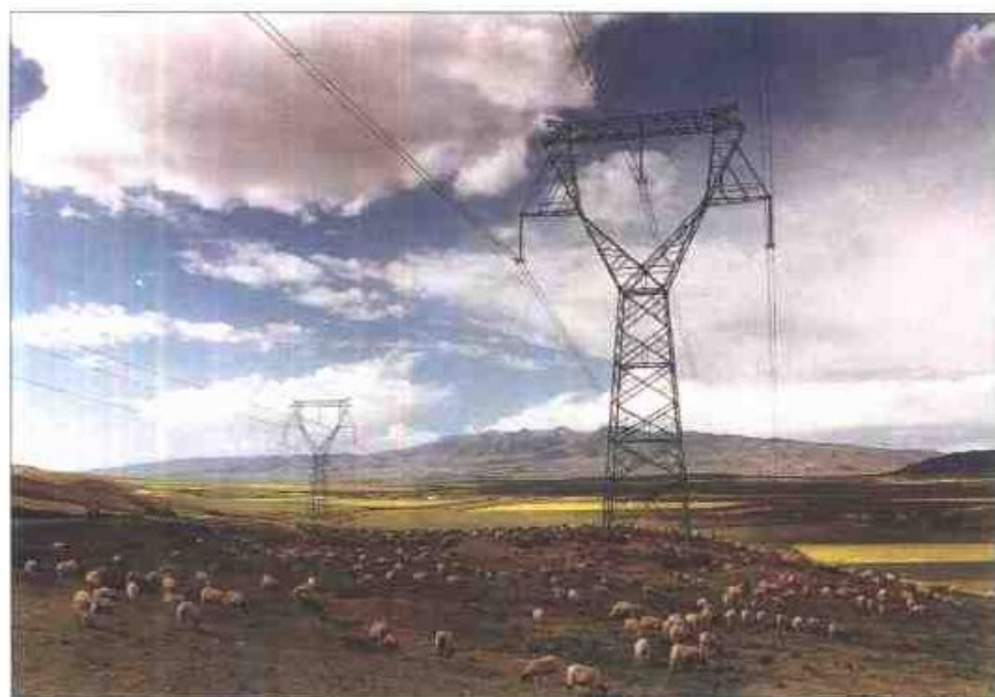
高压输电线路
